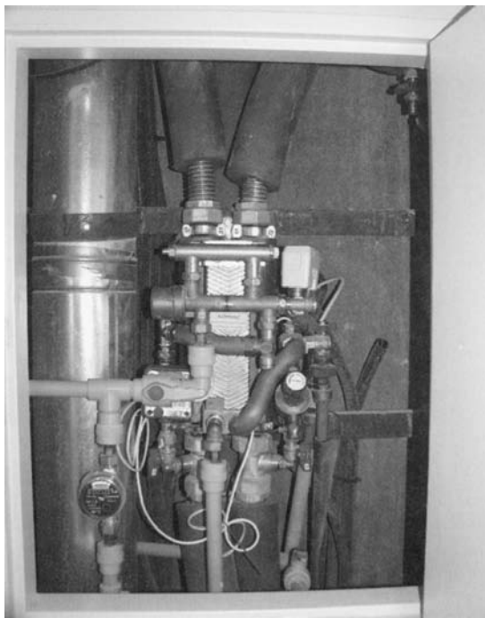
Domovní výměníková stanice
