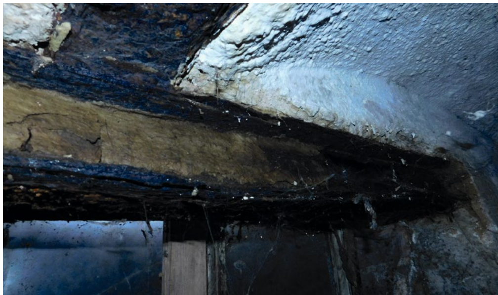
Obrázek 2.5 Pokročilá koroze ocelového nosného prvku stropu
