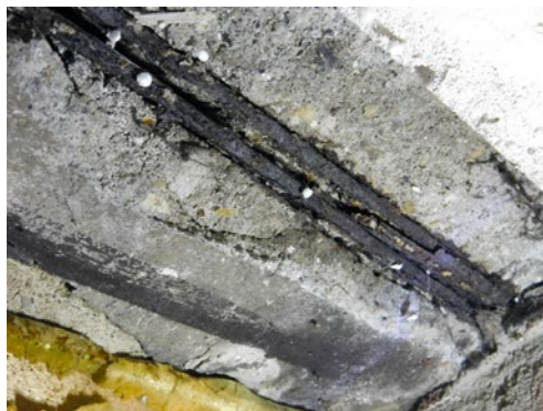
Obrázek 2.6 Pokročilá koroze výztuže železobetonu
