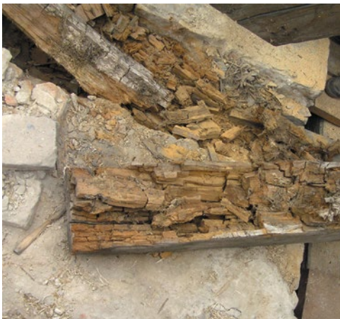
Obrázek 2.4 Biologická degradace dřevěného prvku
