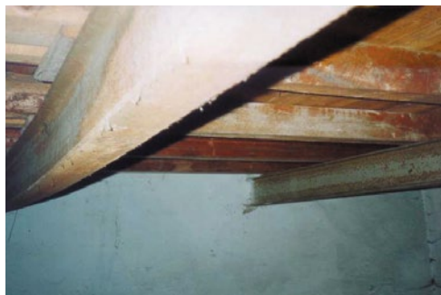
Obrázek 2.1 Nadměrný průhyb stropního trámu
