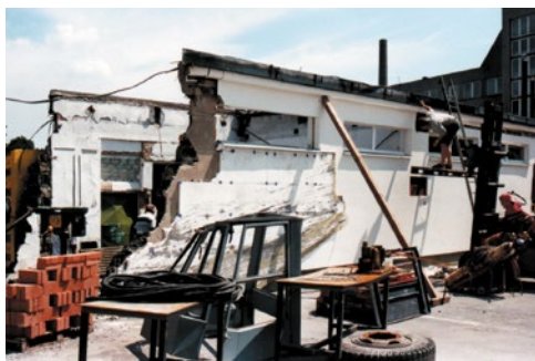
Obrázek 2.14 Destrukce objektu v důsledku výbuchu plynu
